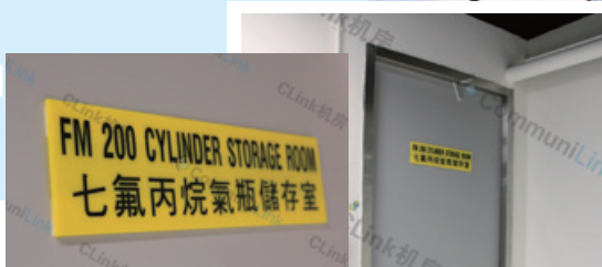
◆ FM200储存室实景图
