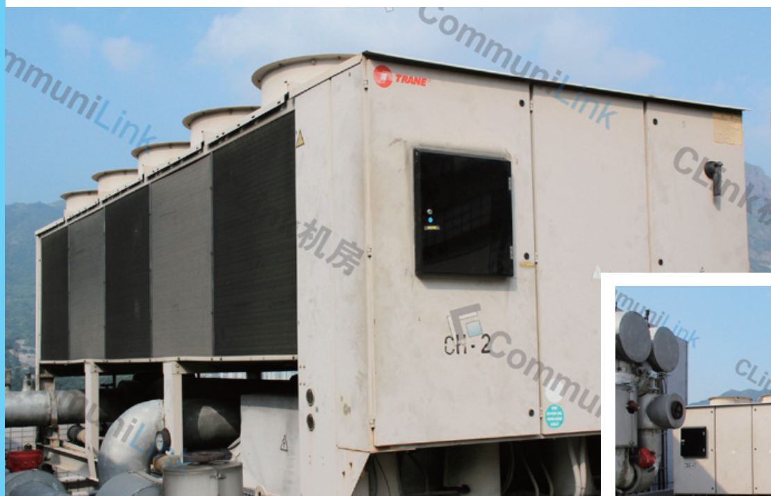
◆ 外部大型中央空调机
